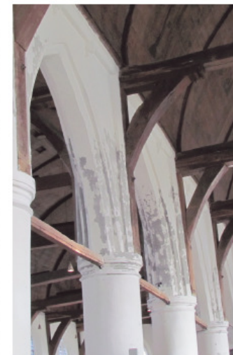
Vocht via het dak zorgde twee maanden na oplevering al voor onthechting van de verf
