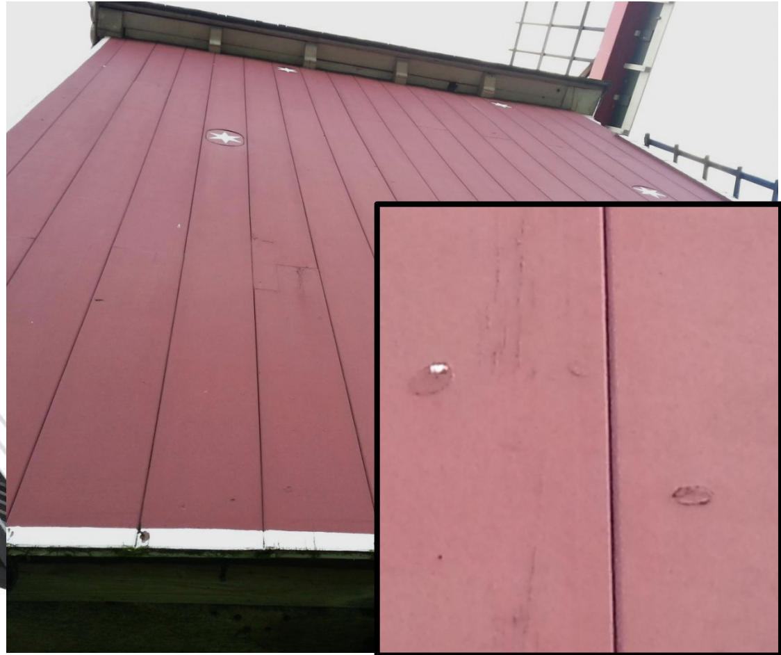
2013: huidige situatie: nauwelijks scheuren
